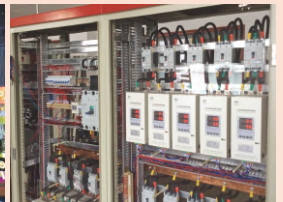
Industrial Control Cabinet 工业控制柜
